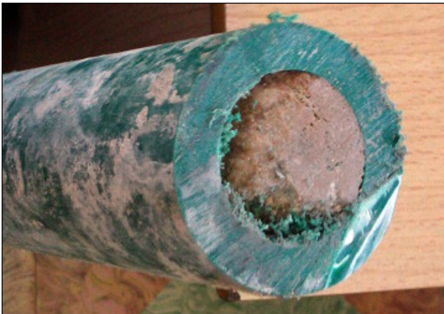
Imagen 1, Tubería de agua potable, no adecuada para aguas duras, 90 días posterior a la instalación
