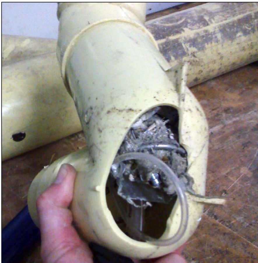
Imagen 2, Sifa sanitaria de material débil (PVC), destruida durante una operación de mantenimiento
