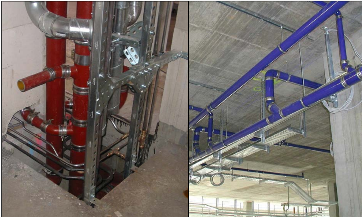
Imágenes 6 y 7, Instalaciones hidro-sanitarias de calidad integral
